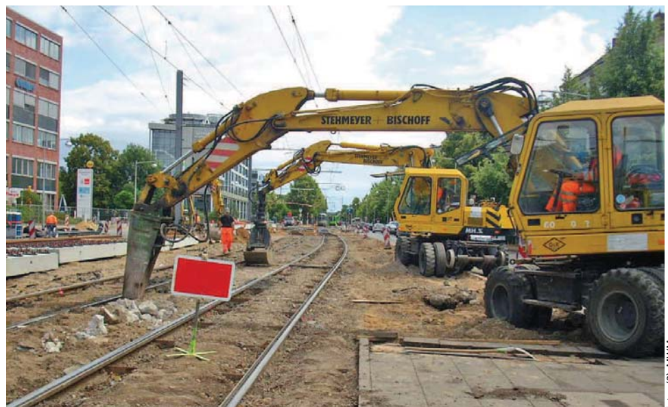
Gleißbaumaßnahme, die mit der REB-Mengenermittlung MWM-Libero vom Dienstleister „HARZing. Bauingenieure“ abgerechnet wird.
